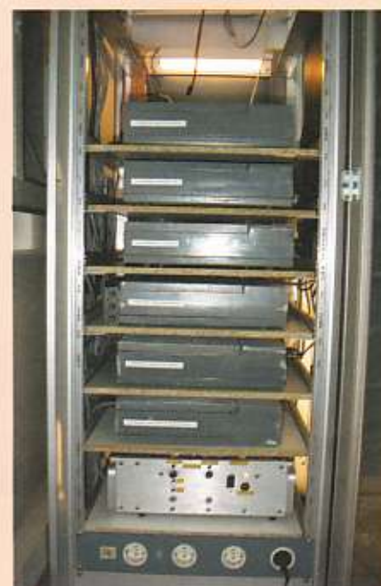
De nieuwe repeater is bijna klaar. De logica moet nog worden gemonteerd en de koeling... want die is hard nodig in de ketelruimte van de Muntflat.
